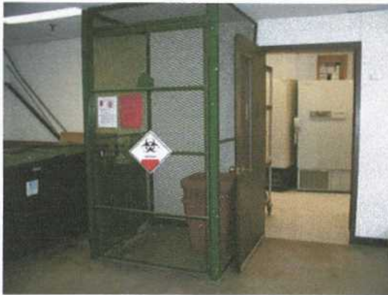
Gambar 1. Contoh fasilitas Penyimpanan Limbah B3 dari fasilitas pelayanan kesehatan dalam ruangan yang dilengkapi dengan pembatas akses (kerangkeng)
